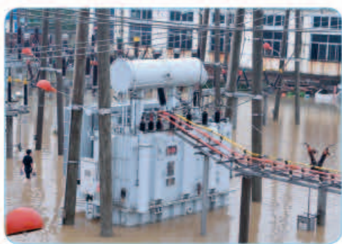
图4.1.1 电力设备被损坏
