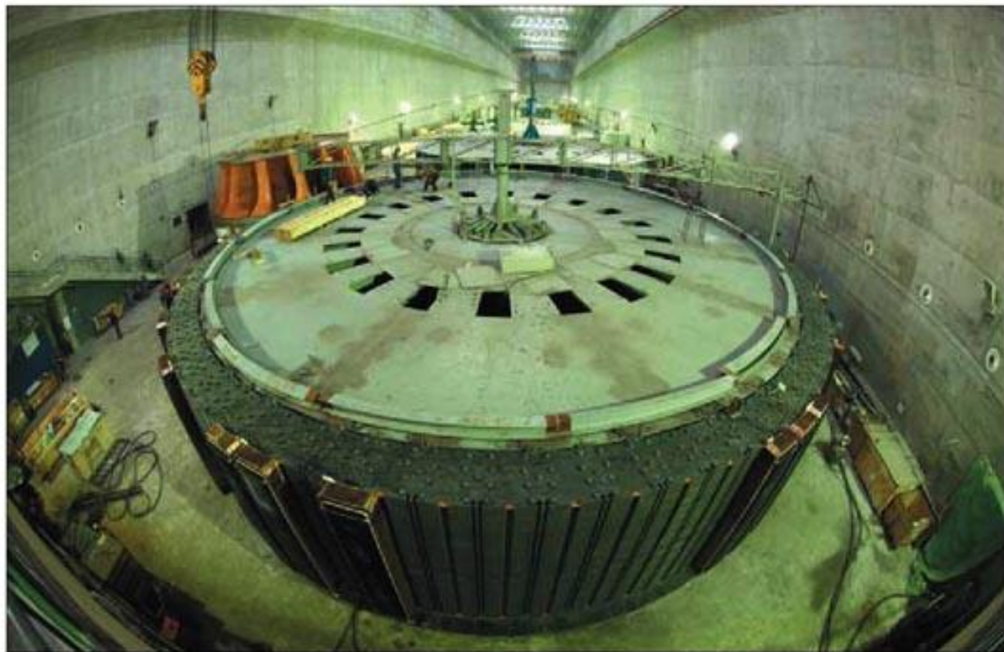
三峡电厂发电机转子
