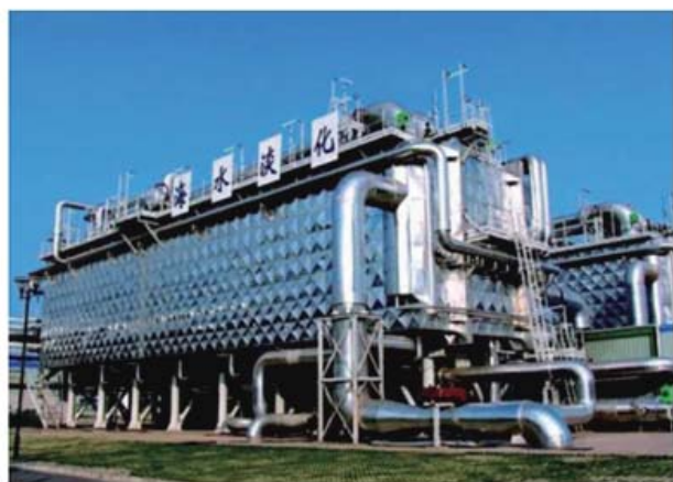
首钢京唐海水淡化工程
