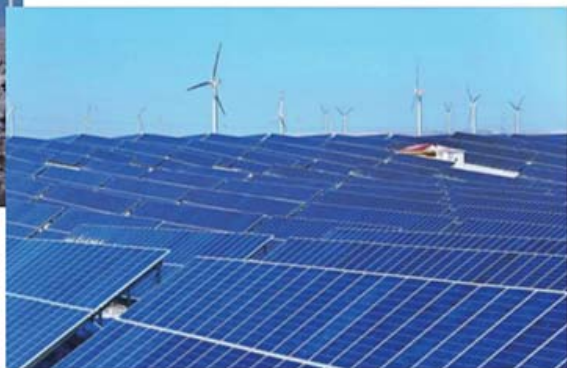
张家口的风电场和光伏电站
