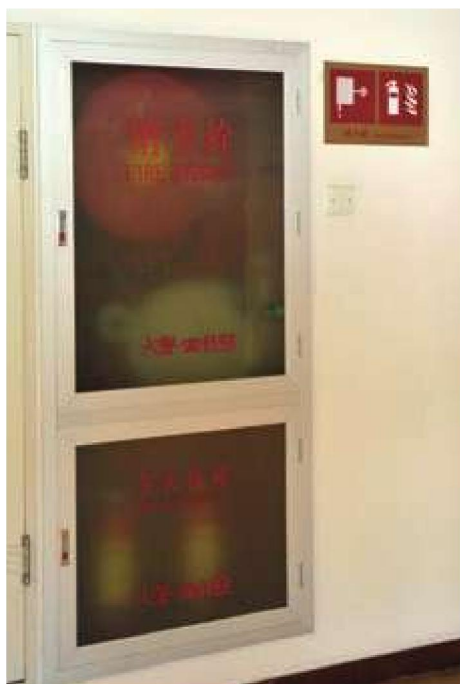
图7-10 建筑物内的消防设施
