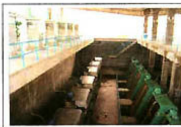
格栅间：除去污水中的大块物体
