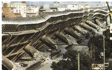
图 1.5 地震毁坏的高架桥
