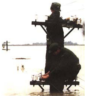
图 1.2 洪灾导致通讯设施中断
