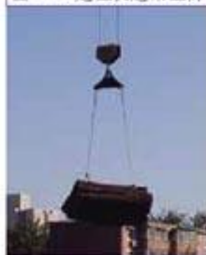
图 1.1-1 起重机起吊重物
