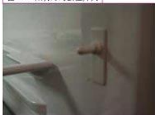
图 5.2-6 照明灯的按钮开关
