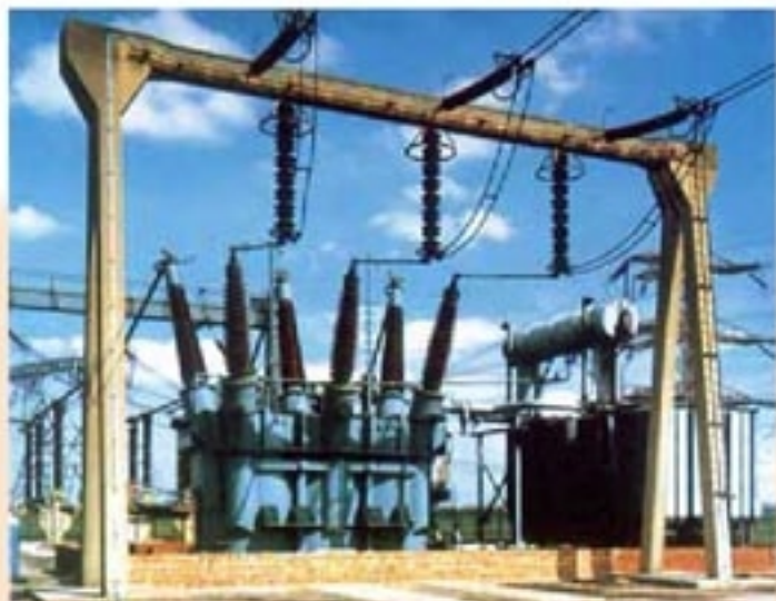
甲 变电站的大型变压器
