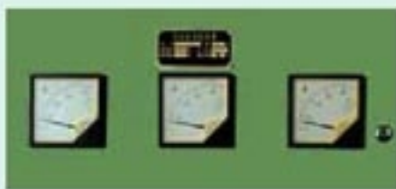
乙 配电板的正面
