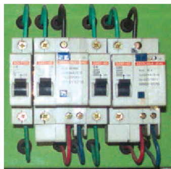
图 9-2-9 家庭配电箱中的空气开关和漏电保护器
