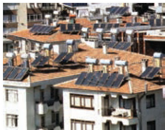
图 11-5-6 架设在屋顶的太阳能集热器
