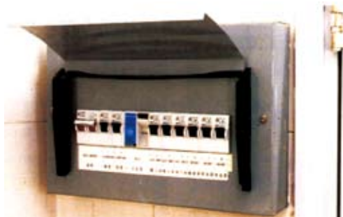
图1-66 安装在电路里的几个断路器
