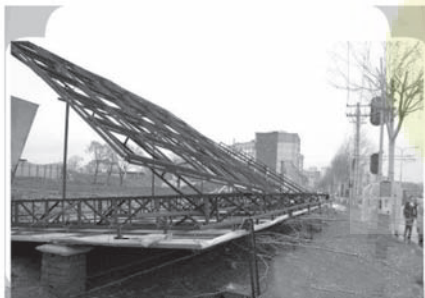
(a) 大风吹倒的广告牌
