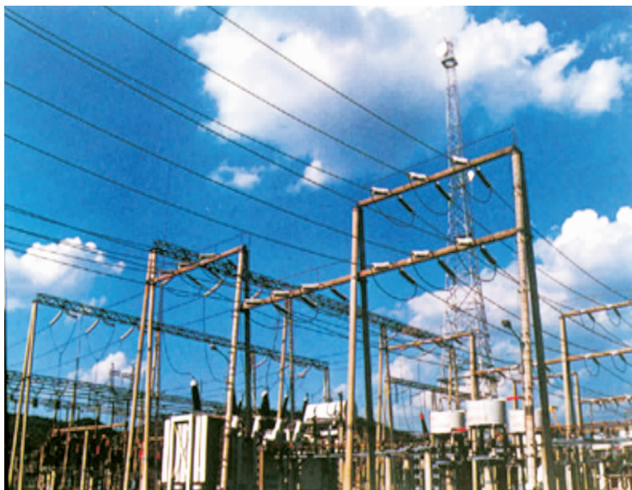
图 3-5-3 电磁污染源：高压输变电站
