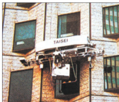
机器人 清洁墙壁
