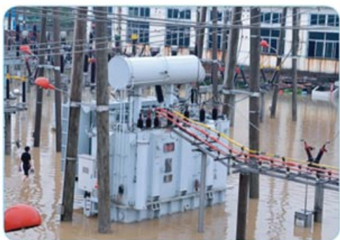
图4.1.1 电力设备被损坏
