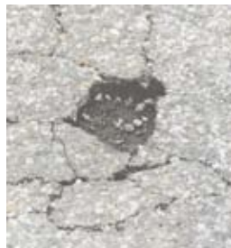
图4-25 水结冰的膨胀使路面形成洞坑
